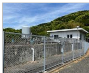
高鶴配水場 (受水)
