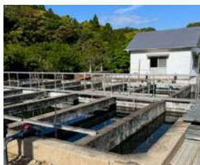
おくやつ 奥谷浄水場
