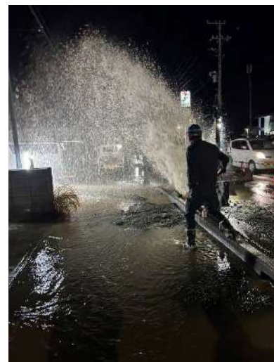
漏水事故の状況
